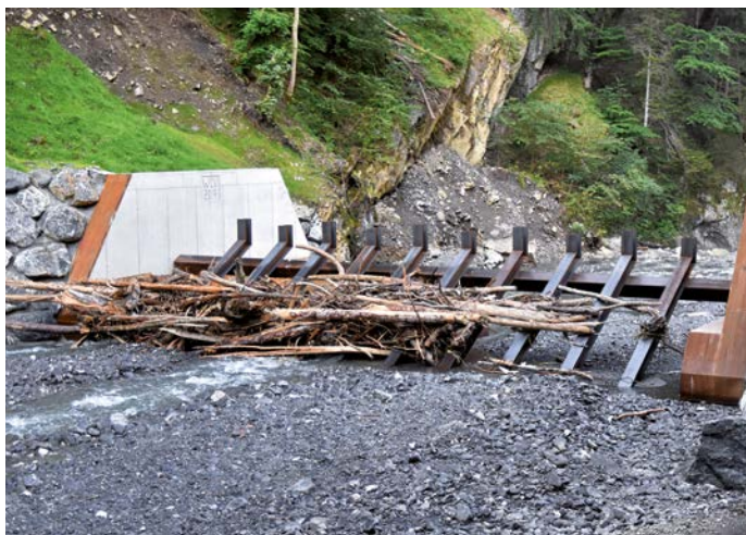
Der neue Wildholz-Rückhalterechen hat sich schon bewährt.
